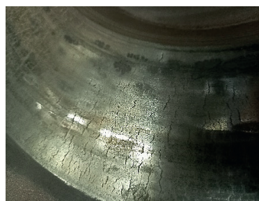
б) усталостные трещины и выкрашивания
